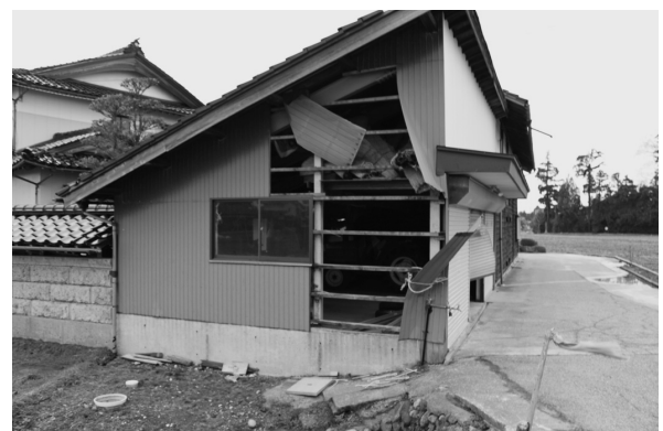
図3 車庫のシャッター、トタンが吹きちぎられた
