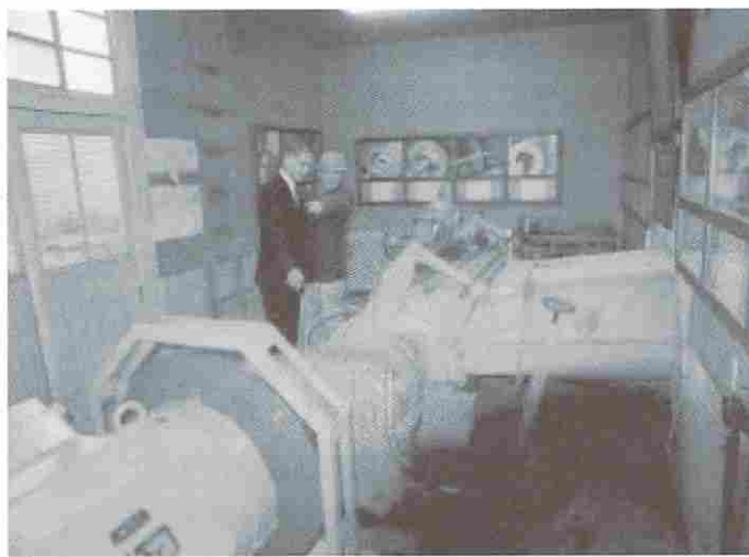
写真2 長野県軽井沢町リゾートホテル自家発電用70kW小水力発電
