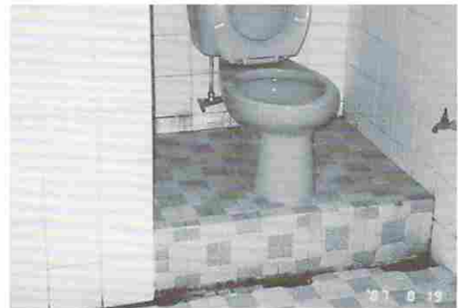
（左側水だめ、ティッシュ・ペーパーはない）
